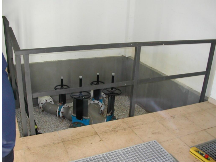
Cámara seca donde se ubican las válvulas del bombeo
