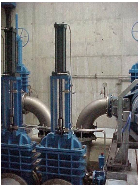
Bombeo en cámara seca con puntos con riesgo de presencia de sh2
