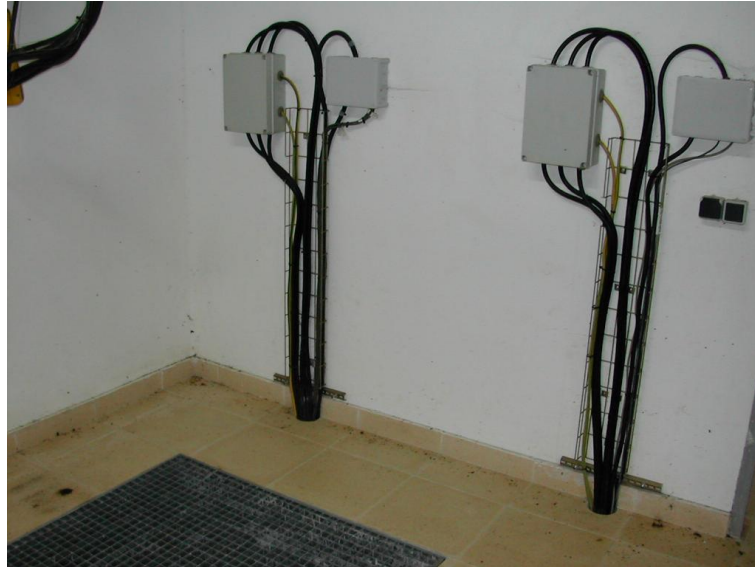
Cajas de conexiones no estancas fuera del pozo de bombeo
