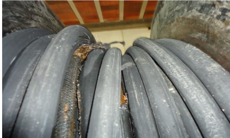
Detalle de manguera de agua a alta presión con desgaste de la goma
