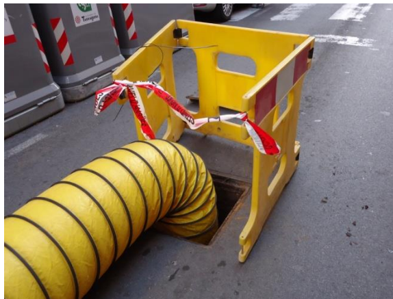
Detalle de ventilación forzada
