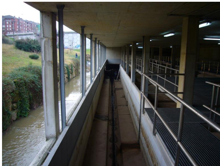
Tanque de tormentas con ventilación natural a la derecha, canal central circulación agua residual y aliviadero a la izquierda.
