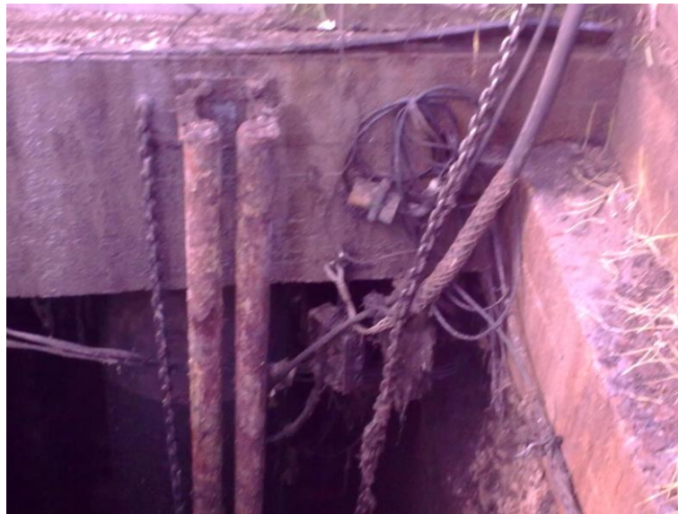
Conexión eléctrica de la bomba mediante caja no estanca con problemas de humedad y riesgo de acceso
