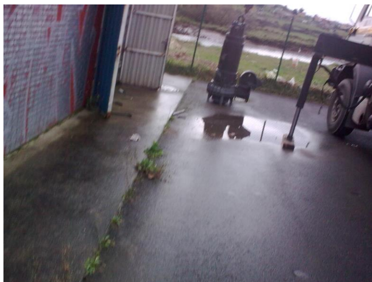
Acceso al bombeo de vehículos pesados para poder extraer las bombas
