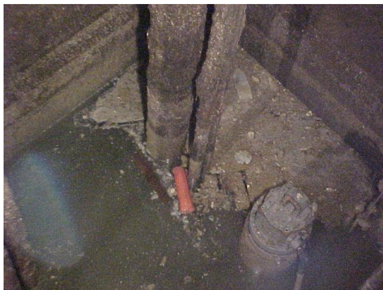
Pozo bombeo con zonas donde se acumulan los sólidos
