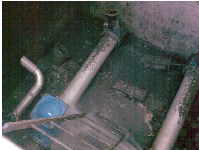
Cámara seca con agua residual donde se ubican las válvulas antirretorno de las bombas
