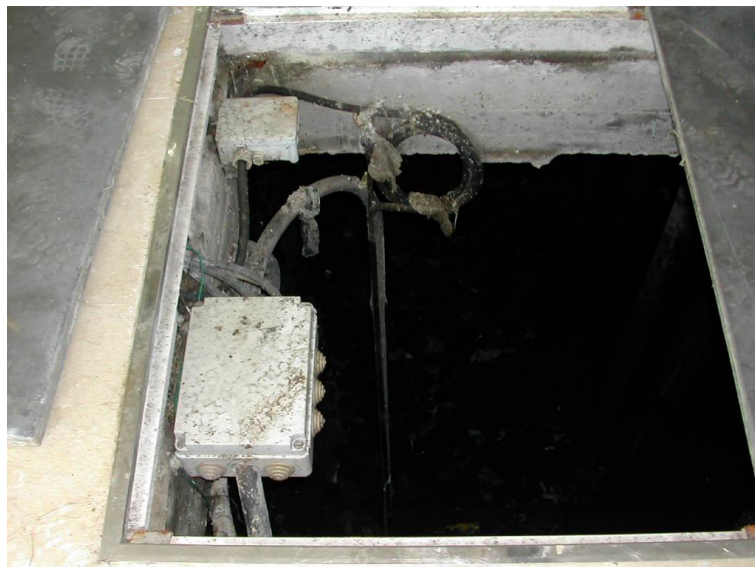
Conexión eléctrica de la bomba mediante caja no estanca en la parte superior del bombeo pero por debajo del nivel de alivio
