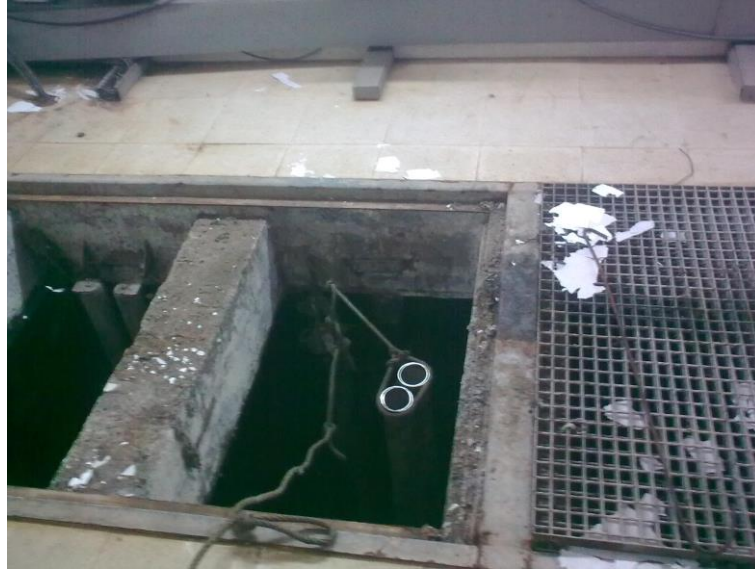
Pozo de bombeo sin trámex para extracción de bomba con grave riesgo de caída
