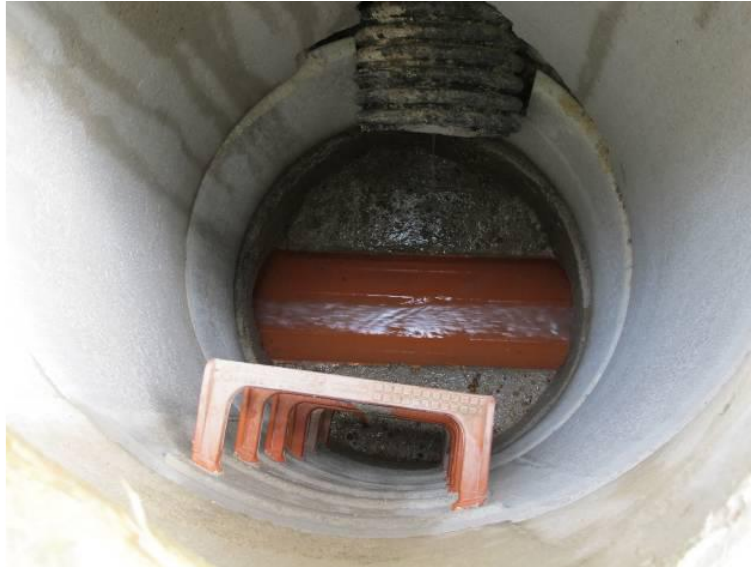
Acometida a pozo con media caña para evitar acumulación de sólidos
