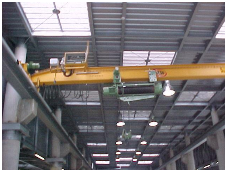
Puente grúa en un bombeo
